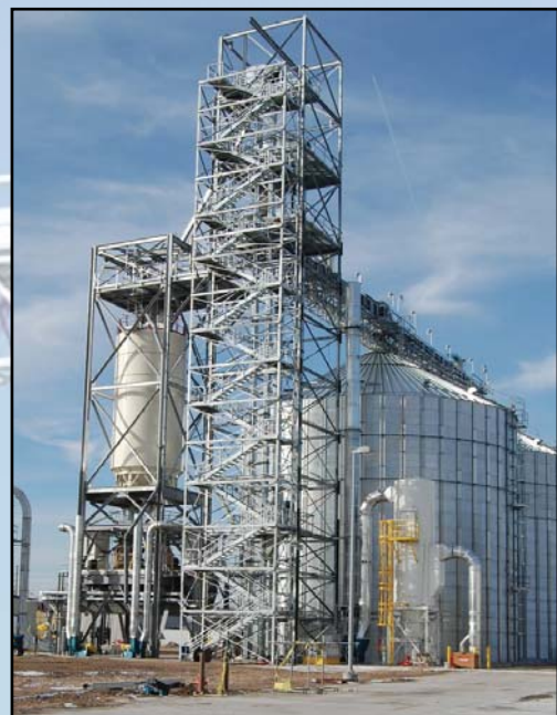
Конструкционная башня 20' x 20' x 136' (6,10 м x 6,10 м x 41,45 м) с самоподдерживающейся перекрестной лестницей.
