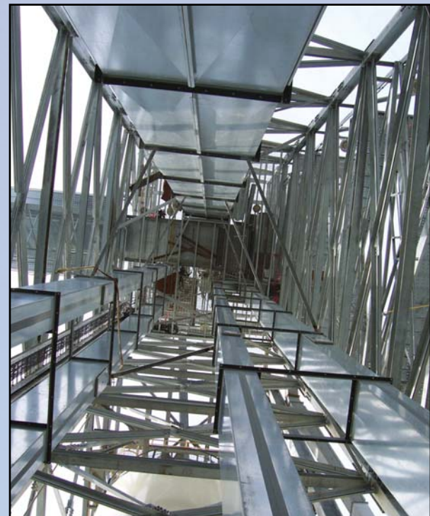
Опорные башни для силосного оборудования сооружаются из колонн, балок и распорок, изготавливаемых из конструкционной стали.
